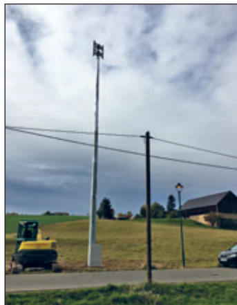
Sirenenmast mit Schaltschrank
