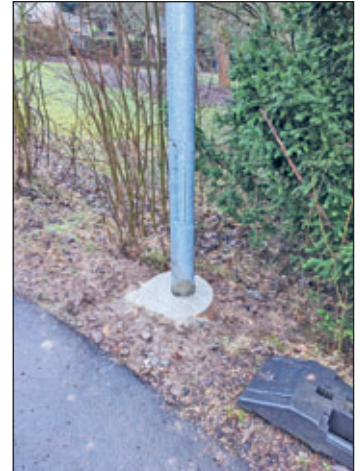
Masthülse mit Beleuchtungsmast
