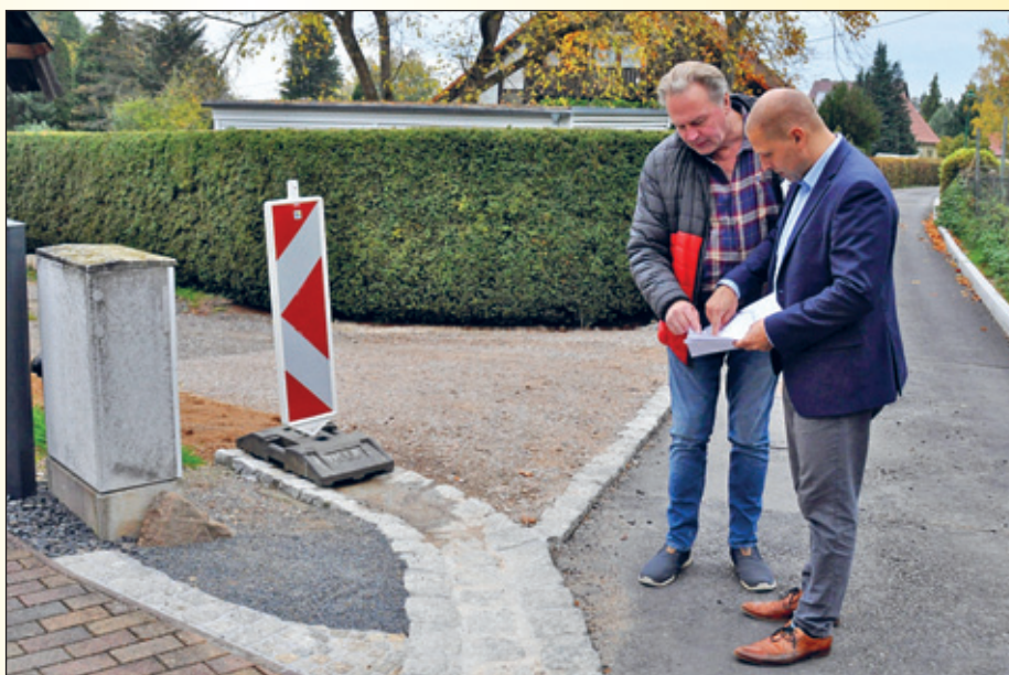
René Streit (l.) erklärt Klipphausens Bürgermeister Mirko Knöfel die außergewöhnliche Variante der Regenwasserableitung.
