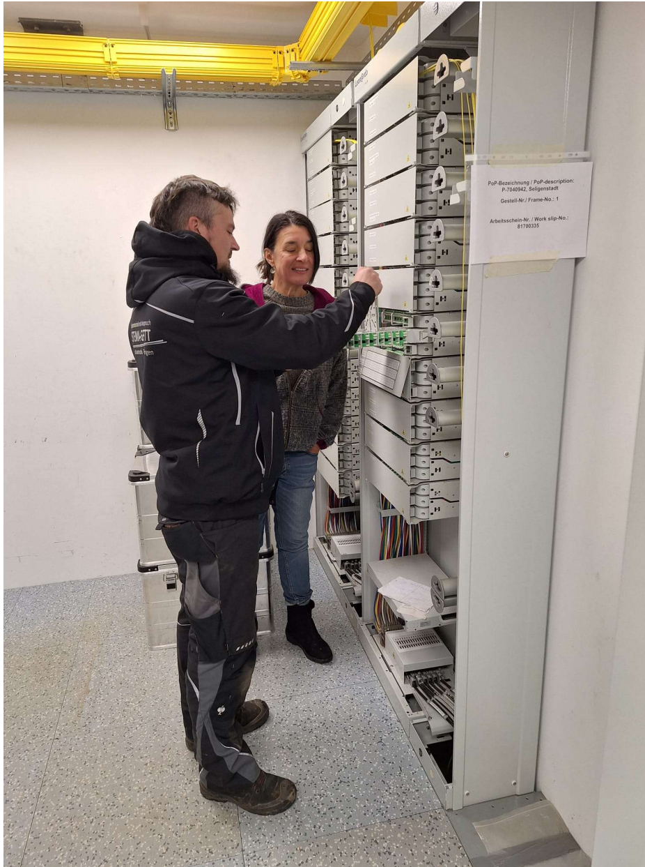
Marcel Unger von Seim & Partner und Christine Weger von Vodafone im POP Seeligstadt bei der Übergabe der restlichen Netzbereiche im Cluster Seeligstadt Ende November 2024
