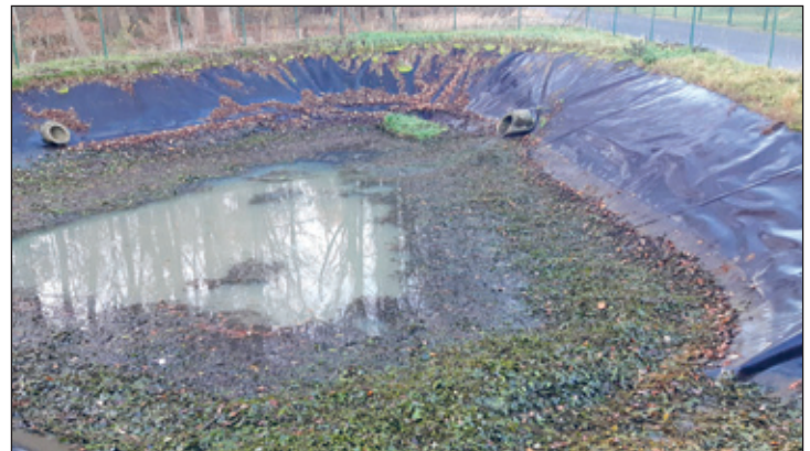
Zustand vor der Reinigung
