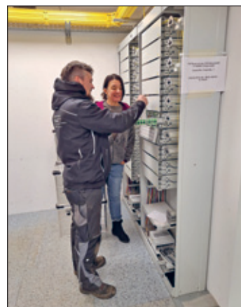
Marcel Unger von Seim & Partner und Christine Weger von Vodafone im POP Seeligstadt bei der Übergabe der restlichen Netzbereiche im Cluster Seeligstadt Ende November 2024
