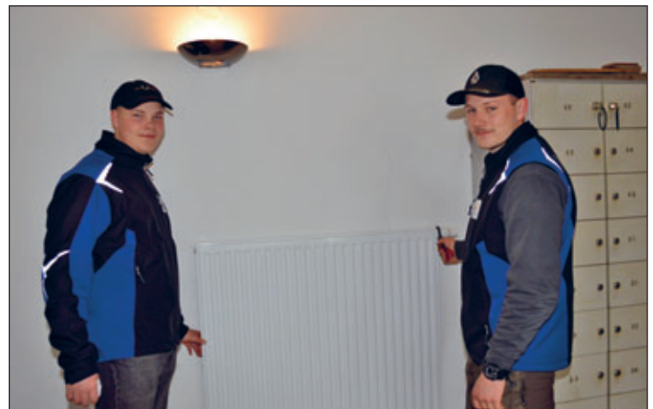
Der Auszubildende der Firma Haustechnik Vogt aus Klipphausen, Nico Wauer (r.) und Meister Bruno Höhne bei der Montage eines Thermostatkopfes.
