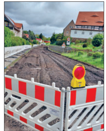
Aufbruch der Straße
